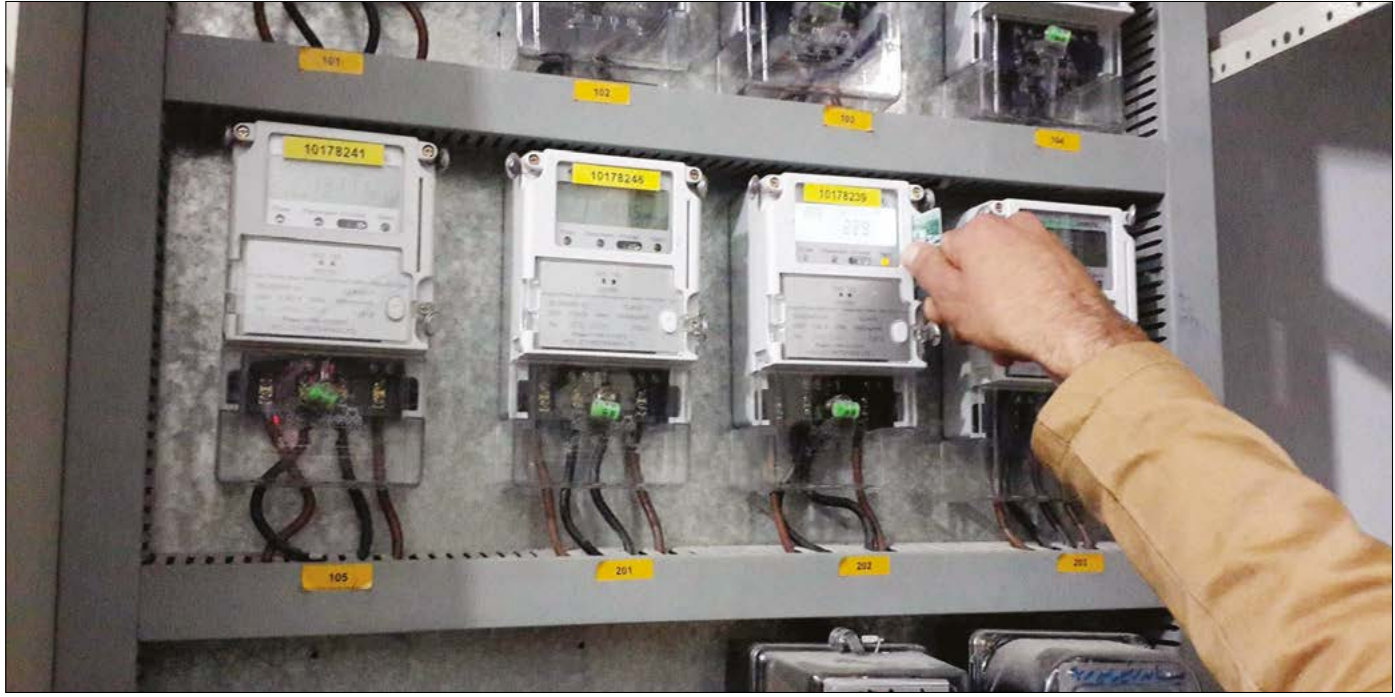
لوحة عدادات كهربائية - إنترنت
