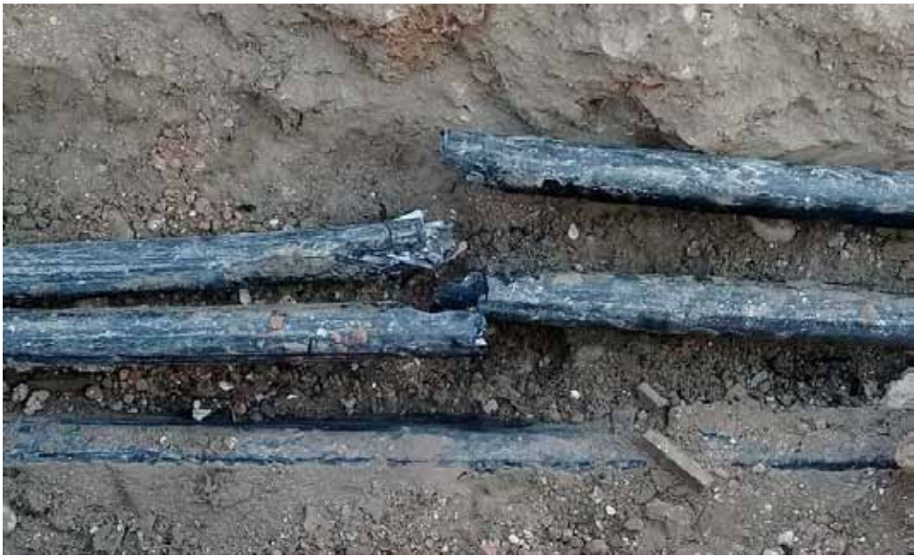
الكابلات الأرضية في مخرج منطقة الشيخ نجار بعد تعرضها لتخريب متعمد | كهرباء حلب
